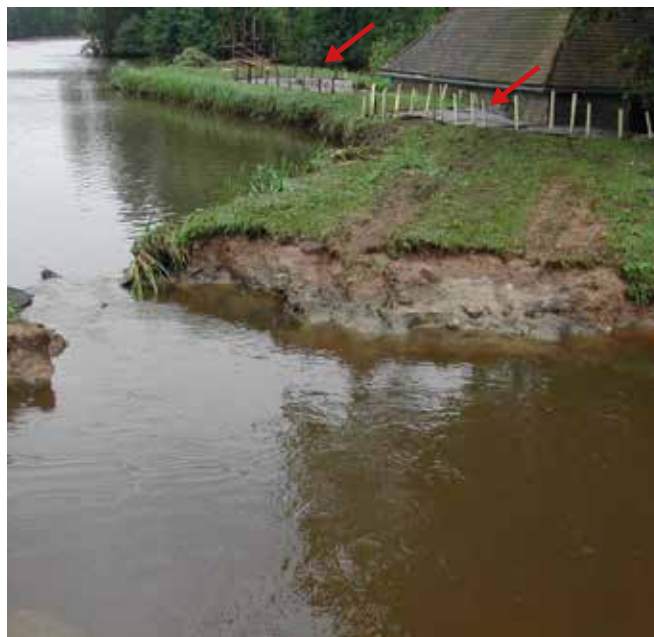
Abb. 43: Notüberlauf an einem Heidenreichsteiner Teich. Die Pfeile markieren die mit Holzpflocken und Sandsäcken gesicherte Folie.
